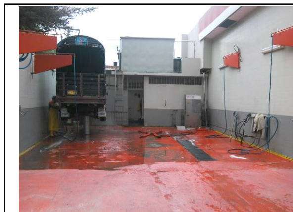
Foto No. 1 – Vista panorámica área de lavado de vehículos, con sistema hidráulico, canales perimetrales cubiertos por rejillas metálicas y pisos en concreto en buen estado.
